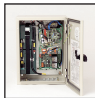
Beoluxstyrskåp med inbyggd batteriback-up.
