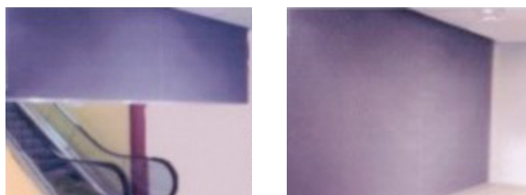
Automatiska rökgasgardiner i nedrullad position. Öppningen tätas av den brandsäkra duken.
